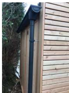
Dachrinne & Fallrohr in PREFA anthrazit
